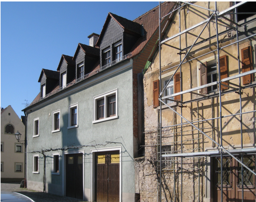
Zu große Dachgauben und Sanierungsbedarf in der Maingasse
